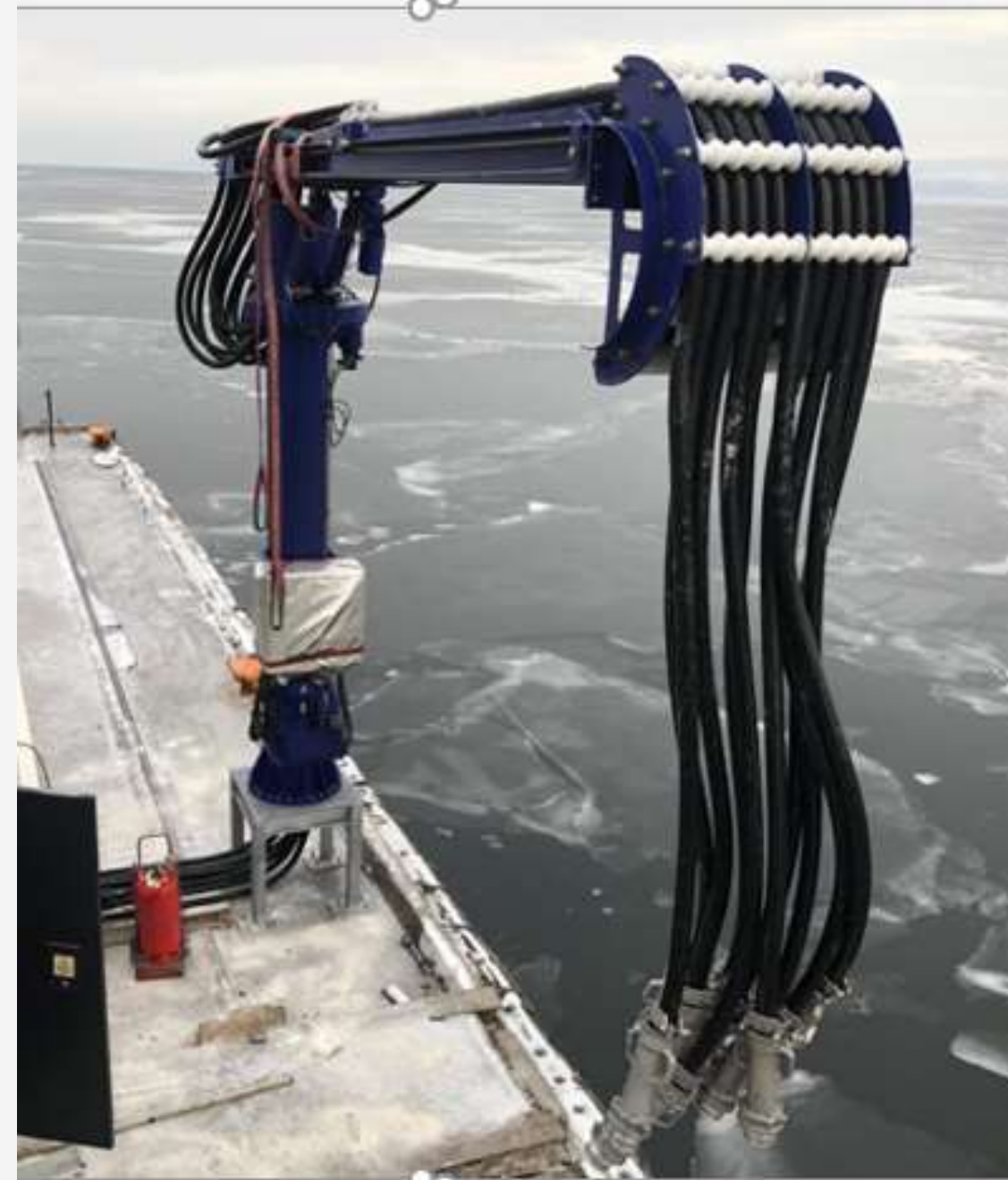
Landstrømanlegg Norcem Slemmestad. 2 MW anlegg for utslippsfri lossing sementen til toppen av de høye siloene. reduksjon i dieselbruken på 3-5000 liter per skip. Enova støtte: 4,7 millioner kroner. Totalkostnad ca. 9 millioner. Bilde: Norcem nettside.
