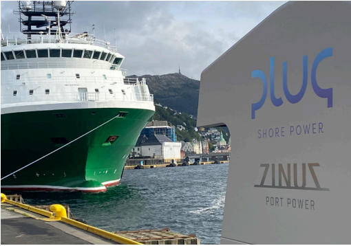
2. plass i Årets lokale klimatililtak 2020: Bergen kommune/Bergen havn for «Europas største landstrømlegg for skip».
