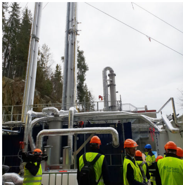
Karbonfangstanlegget på Klemetsrud i Oslo. Foto: Oslo Fortum Varme AS
